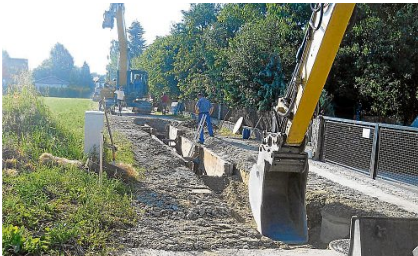
Arbeiten abgeschlossen Die Kanalbauarbeiten in Dünzelbach sind abgeschlossen. Die Wiederherstellung der Asphaltflächen und des Kiesweges mit einem Grader erfolgt noch. FOTO: TB
