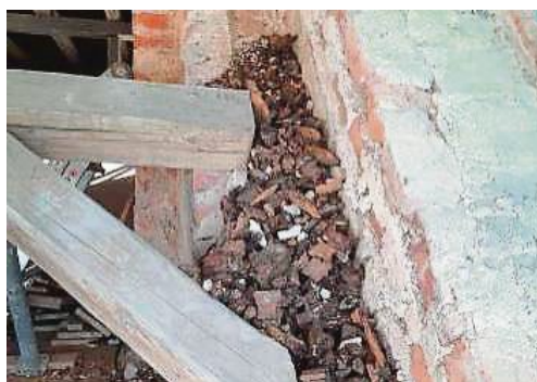
Der gesamte Dachstuhl wird von den Schäden...
